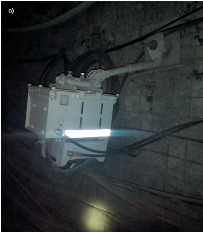
Рис. 1. Базовая станция – основной компонент для организации подземной инфраструктуры связи (кабельной и беспроводной) в системе наблюдения, оповещения и поиска людей, застигнутых аварией, «SBGPS»: а) – вид общий; б) – технические характеристики
