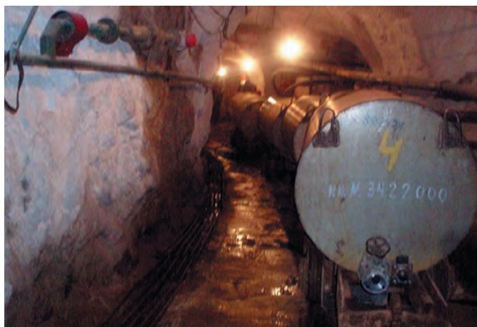
Рис. 4 Сорбционные колонны СНК в выработках
