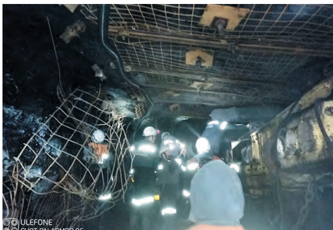
Рис. 1 Фото объективных и реальных разрушений в призабойном пространстве монтажной камеры 4-1-5-8 (2) после горного удара 24.03.2024 г.
