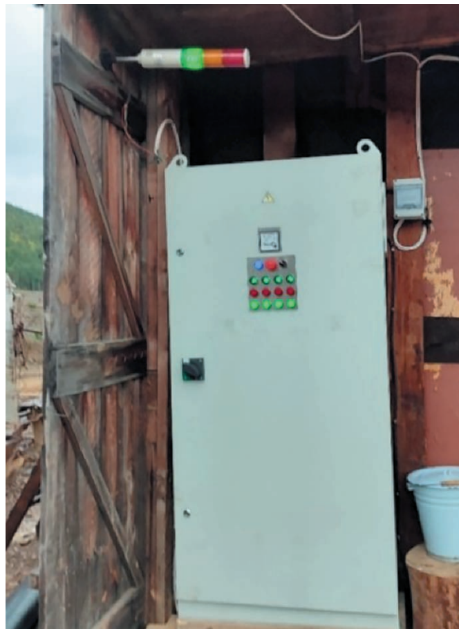
Рис. 2 Шкаф управления промприбором с сигнальной колонной
